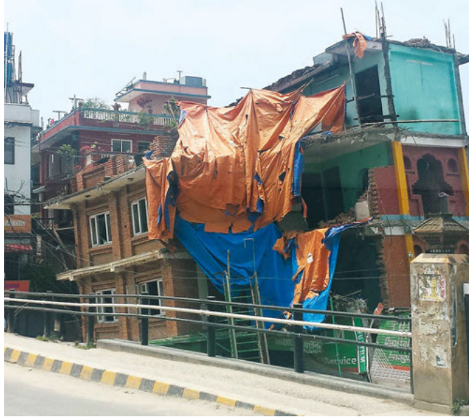
Hauszerstörung durch das Erdbeben
