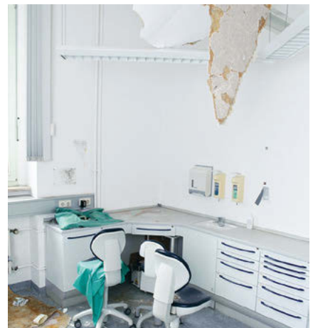
Nach dem folgenschweren Wasserschaden im Jahr 2012 konnte das Gebäude nicht mehr saniert werden.
