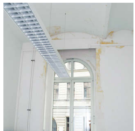
Durch ein defektes Ausbrühergerät lief das auslaufende Wasser ein Wochenende lang vom 2. Stock bis in den Keller der Zahnklinik.
